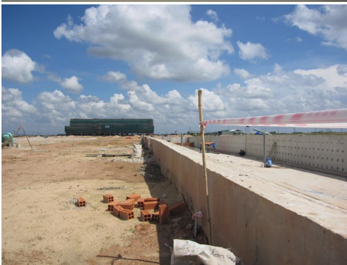
Kết cấu bị đẩy nổi
