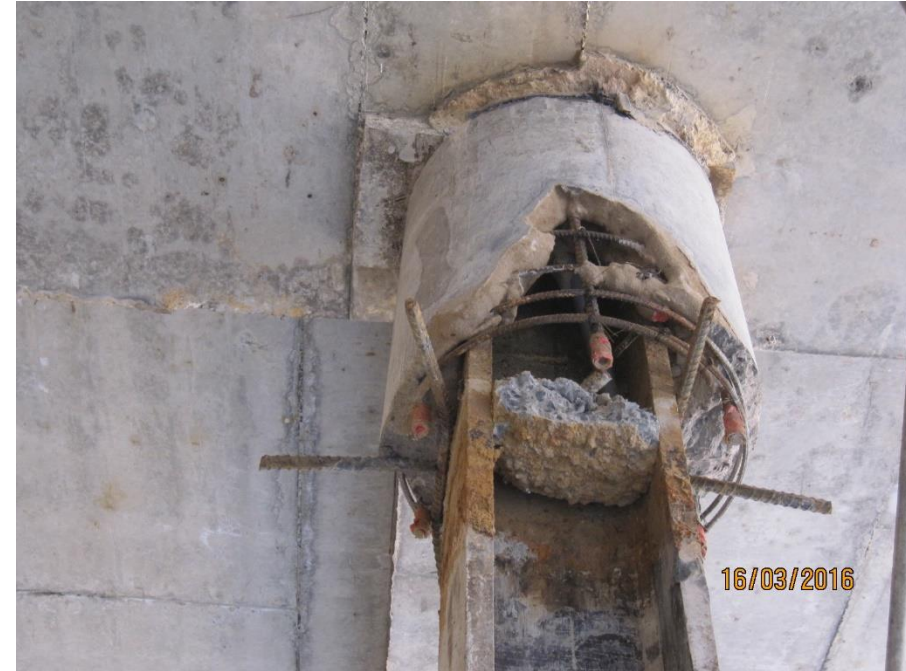
Bê tông đầu cột bị mất nước
