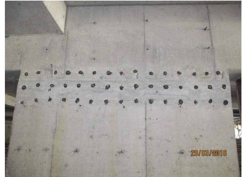
Grouting đầu cột không đạt chất lượng
