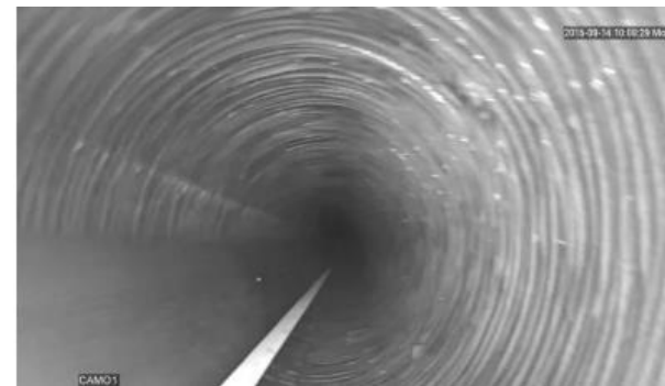
KIỂM TRA VẾT NỨT CỌC (CAMERA)
