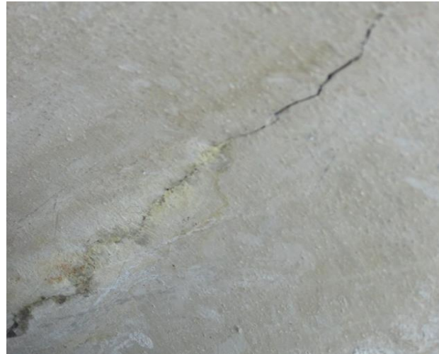
VẾT NỨT CỌC
