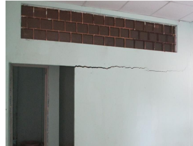
NỨT TƯỜNG NHÀ
