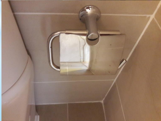
SAI : Lắp thiết bị sai vị trí
