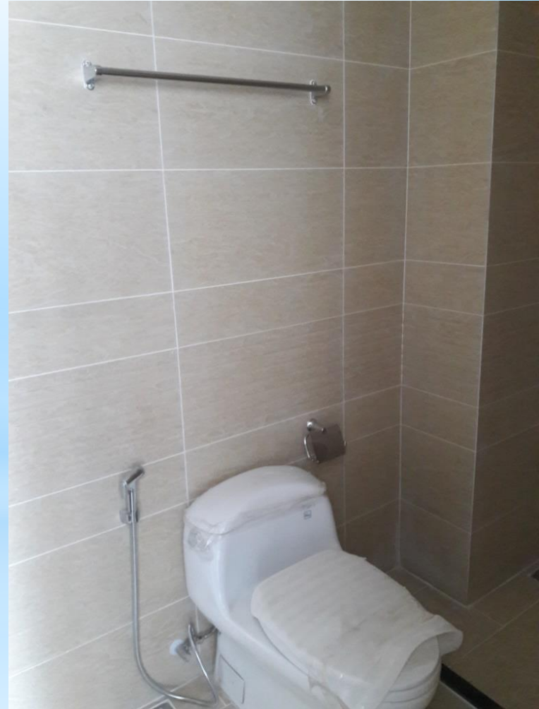
SAI : Lắp thiết bị sai vị trí
